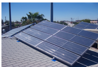
Fig. 5 Solar Thermal Collectors
